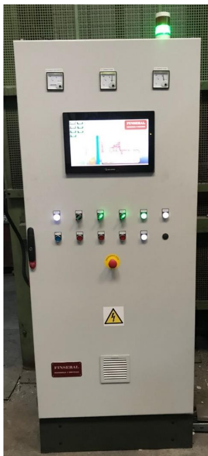
Antiguo sistema de control De temperaturas de la Torre fusora
